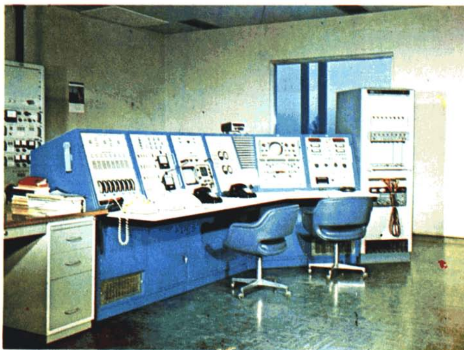
Γενικός πίνακας έλέγχου του δορυφορικού σταθμού έδάφους «Θερμοπύλαι».
