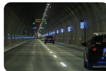
Σχήμα 8.31: Φωτισμός σε σήραγγα
